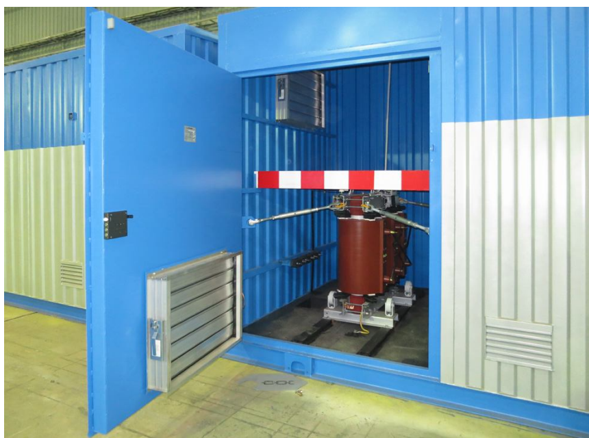
Отсек силового трансформатора
